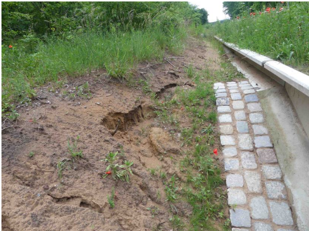
Vom Starkregen im Mai abgesackte Böschung
