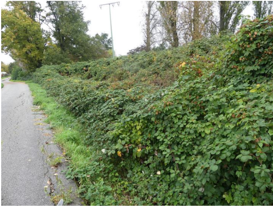
Brombeerbewuchs verdeckt den Grabenabschnitt
